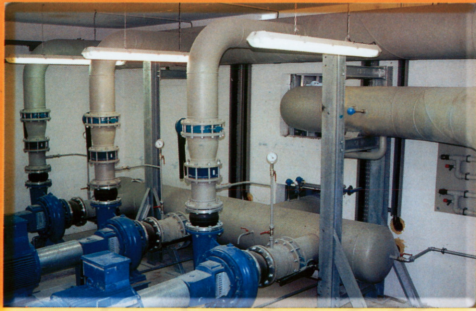
Salles de pompes - Usine d'incinération (Anncy)
